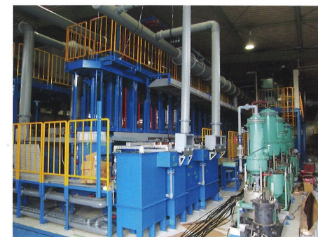
エレベータ式めっき装置 Elevator type
